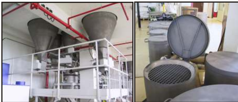
Obr. 4.: Pohled na zásobníky se surovinou a vstup do zásobníků
